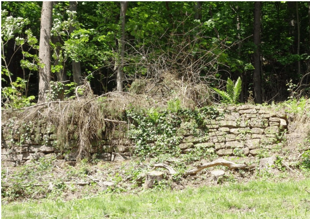
Abbildung 45 und 46: Bei beiden abgebildeten Trockenmauern sind wie auch bei vielen anderen Mauern des Gebietes Sanierungsmaßnahmen erforderlich. Der Bewuchs muss zurück geschnitten werden. Foto: 15.05.2019
